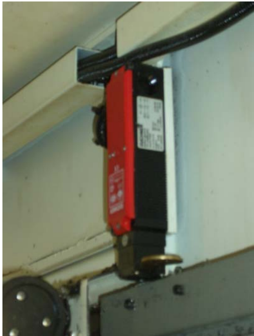
Abbildung 5: Manipulation eines Positionsschalters an einer Schutztür
