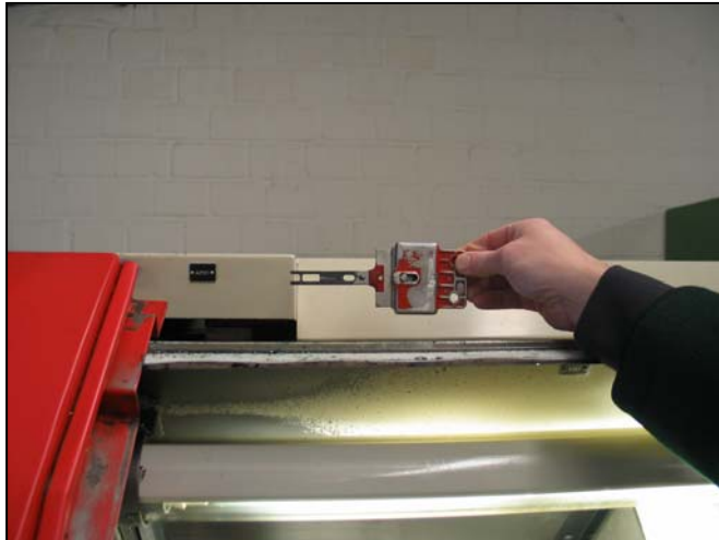
Abbildung 9: Manipulation eines Positionsschalters an einer Schutztür
