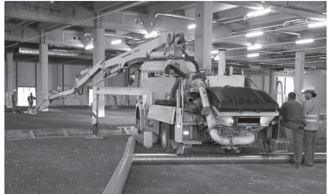
Bild 4. Betonpumpe in einer Halle mit Absaugung am Auspuff.
